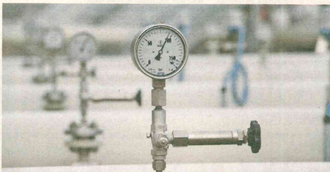
Messgerät an einer Erdgasleitung: Das bestehende Netz soll zum Wasserstofftransport genutzt werden.
